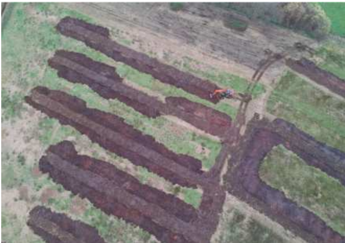
Figuur 22 Het dempen van ontwateringsgreppels in de vallei van de Zwarte Beek (bron: www.vlm.be )
