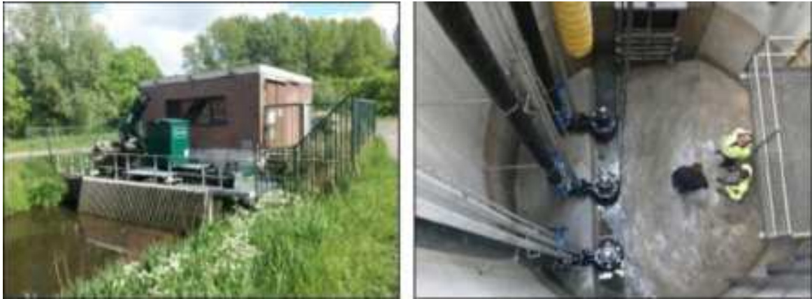
Figuur 21 Pompgemaal in polder van Sinaai-Daknam. (bron: www.vvwp.be )
